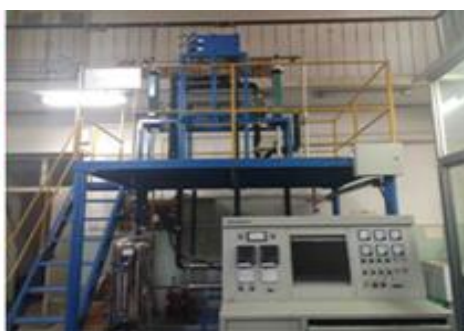
化工智能实训平台
